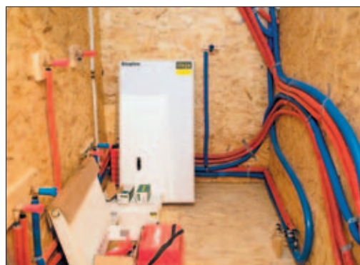
Коллекторный узел в котельной. Viega Smartpress объединяет преимущества металлических и пластиковых трубопроводных систем. Отличные гидравлические характеристики труб и фитингов сочетаются с быстротой, надежностью и удобством монтажа
