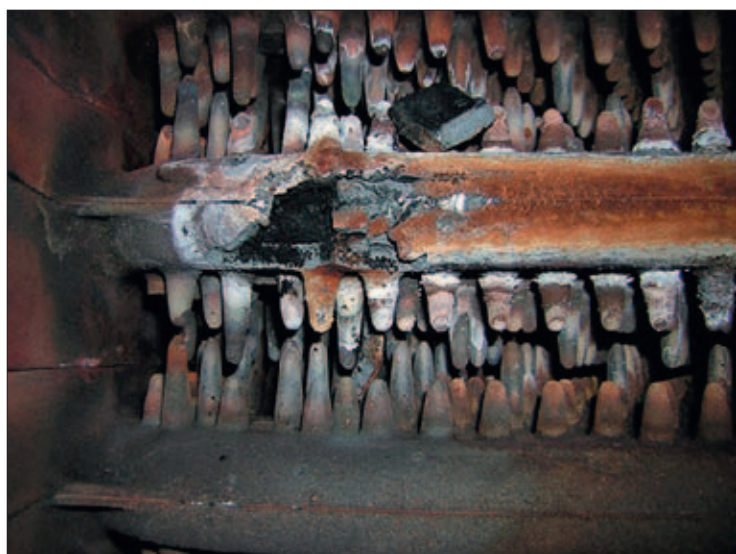
Рис. 3. Разрыв теплообменника от температурного шока
