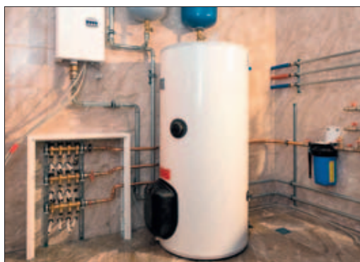
Управление электрическим котлом осуществляется удаленно, через GSM-модуль. Таким образом, контролировать ситуацию в доме можно даже из-за границы
